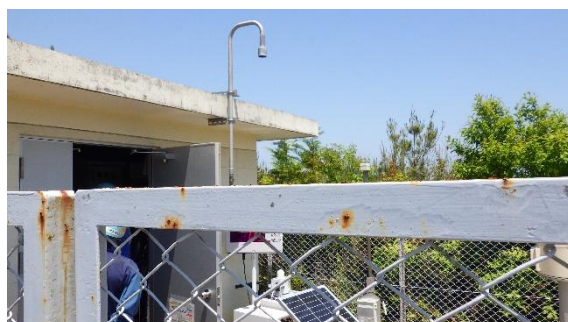
(写真3-5) モニタリングポスト (No. 1) の状況 (ダスト採取口)
