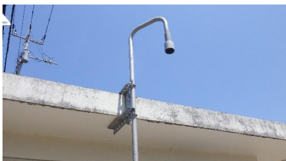
(写真3-6) モニタリングポスト (No. 2) の状況 (ダスト採取口)
