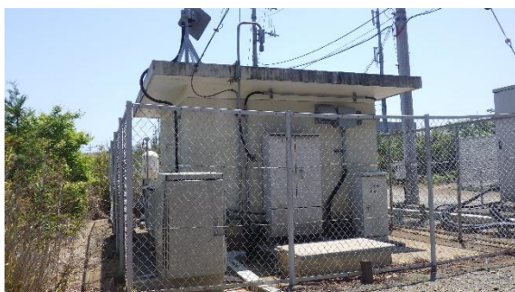
(写真3-2) モニタリングポスト (No. 2) の状況 (全景)
