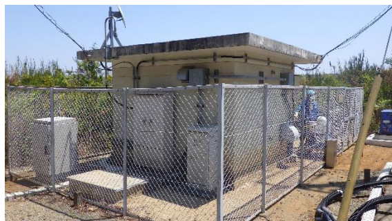
(写真3-1) モニタリングポスト (No. 1) の状況 (全景)
