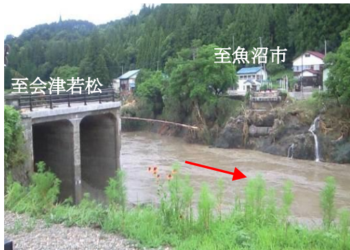
落橋後の状況
