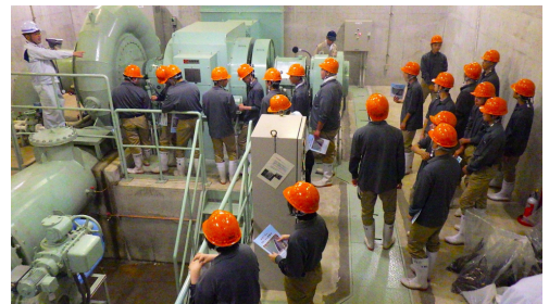
▲「新宮川ダム」農業用ダム管理
