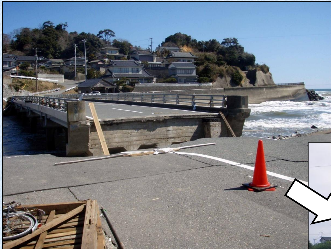
橋台背面崩落〔県道久ノ浜港線〕
