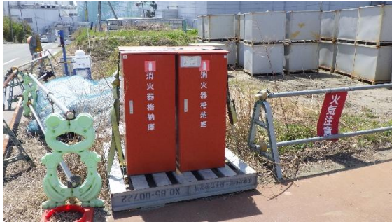
(写真5) 消火器の設置状況
