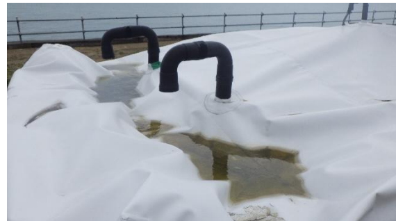
(写真2) 窪みに溜まった雨水
