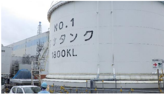
(写真1-1) 1号機CSTタンク外観
