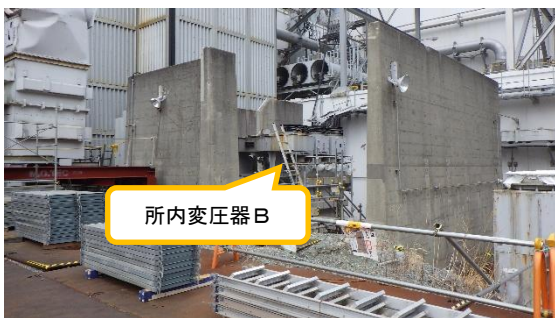
(写真4-1) 所内変圧器Bの状況
