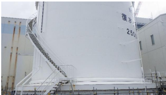
(写真1-3) 2号機CSTタンク外観
