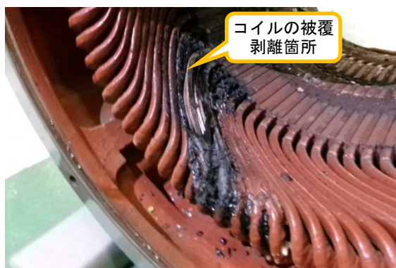
(写真7) RCW2ポンプ (A系) モータのステータ部のコイル被覆の剥離状況
