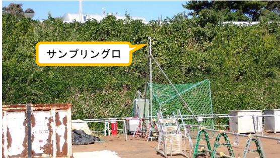
(写真7) ダストモニタ設置状況
