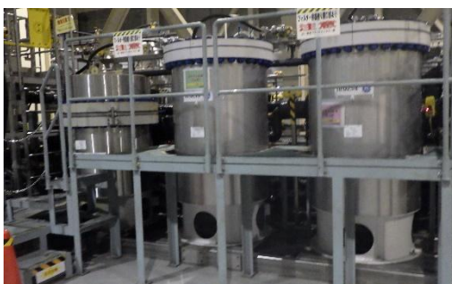
(写真1-2) 前処理フィルタの設置状況 (A系：3基)
