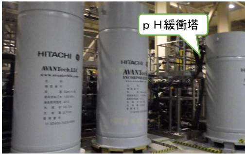
(写真 1 - 3) pH緩衝塔の設置状況
