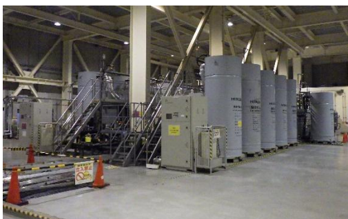
(写真1-1) サブドレン他浄化設備建屋内部の 状況
