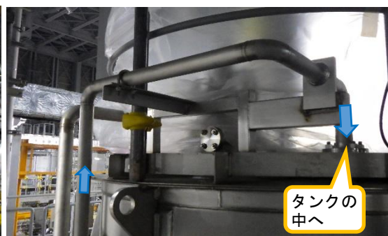
(写真4-2) 吸着塔入口バッファタンク上部の配管の接続状況
