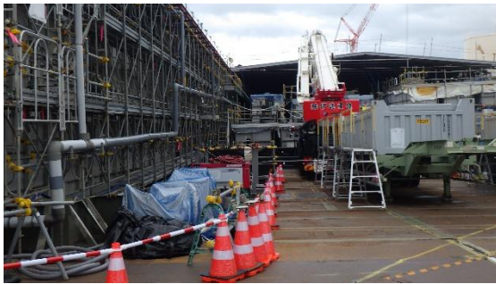
(写真4②) エリア奥のノッチタンクの保管状況 ※詰替えが完了した手前側の屋根は、 既に撤去済みとなっている。
