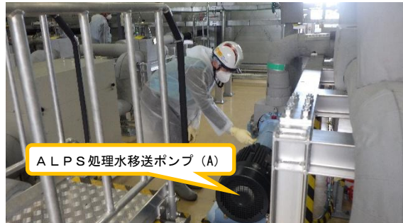
(写真2②)ポンプの稼働状況確認
