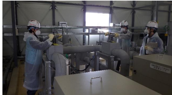
(写真1④)多核種移送設備建屋での弁操作
