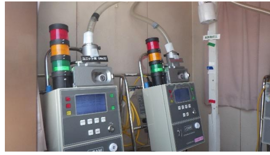
(写真4) ダストモニタの設置状況
