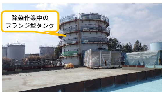
（写真1）フランジ型タンクの全景
