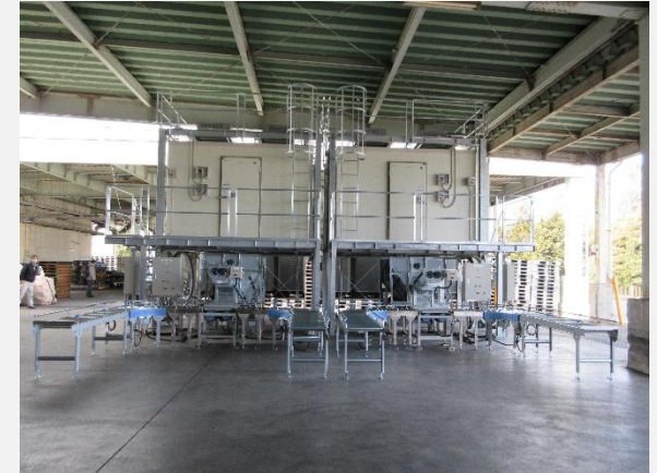
写真3 ブロッコリー製氷設備
