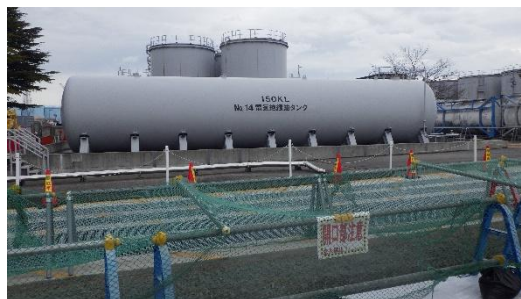
(写真2-1) 絶縁油タンクエリア西側の状況
