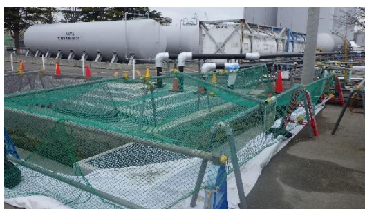
(写真 2-2) 絶縁油タンクエリア西側の状況
