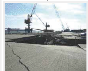
被災した小名浜港7号ふ頭（いわき市小名浜）
