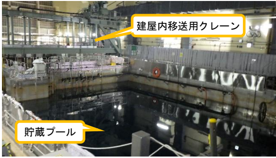
(写真 2-1) サイトバンカ建屋 2 階貯蔵プールに おける高線量機器類の収納状況①
