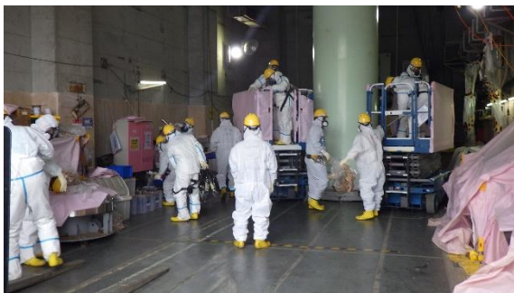
(写真 3-2) サイトバンカ建屋大物搬入口におけ る除染作業状況②
