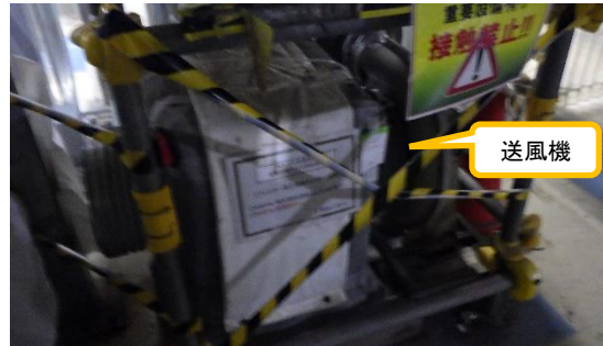
(写真1②) 塩害対策ハウス用送風機の設置状況
