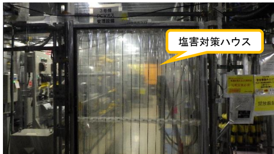
(写真1①) 塩害対策ハウスの設置状況
