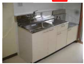
⑤台所の水栓更新(シングルバ-混合水栓付き)
