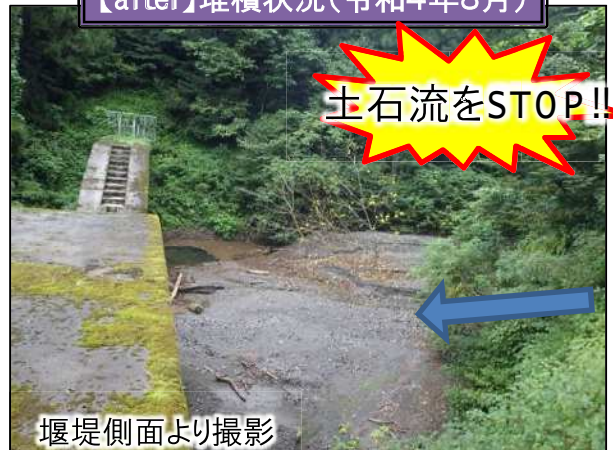
【after】堆積状況(令和4年8月)
