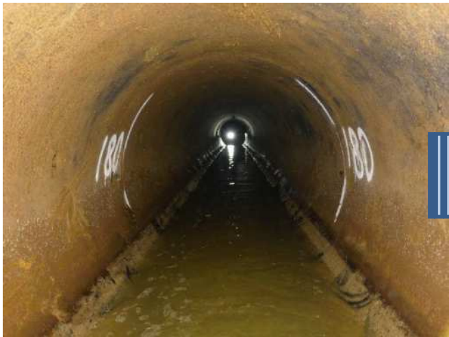
耐震性能不足の管渠
