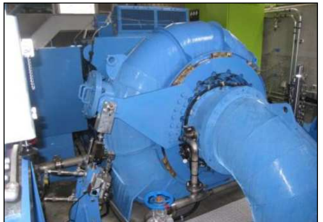
発電所内 横軸フランシス水車
