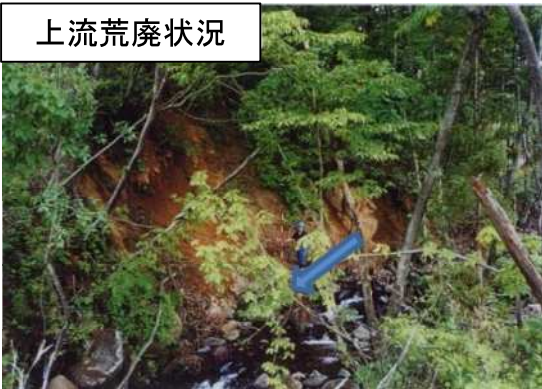
溪岸浸食状況
