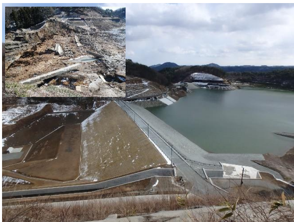
東日本大震災で決壊した藤沼湖の復旧 ※左上:被災時の状況
