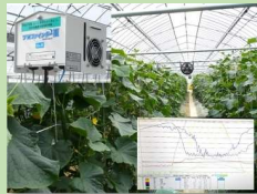
園芸施設の環境測定装置
