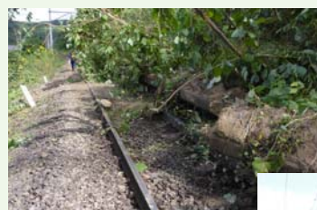
▲ 被災直後 (令和元年10月)
