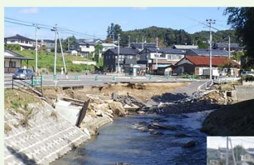
▲ 被災直後 (令和元年10月)
