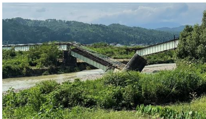
JR磐越西線の橋梁倒壊（喜多方市）
