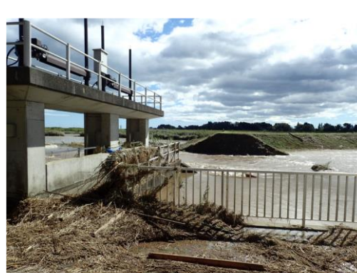
排水機場被害（相馬市）
