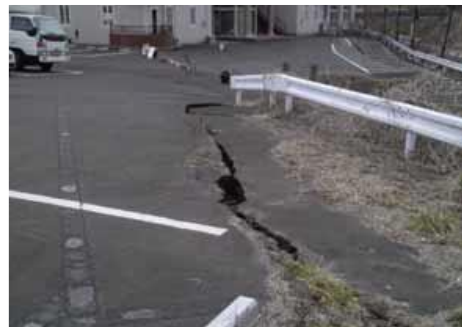
(b)のり肩の亀裂
