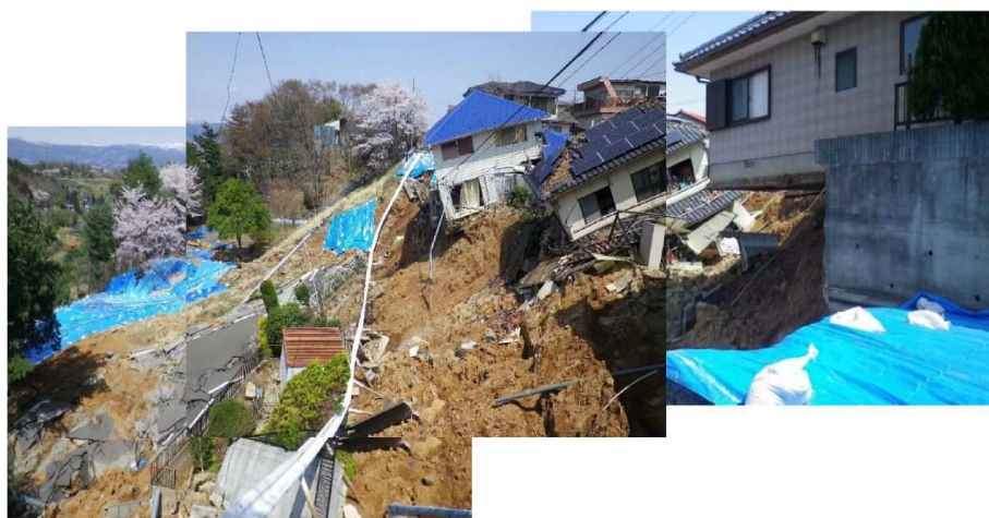
写 3-11 のり面の崩壊の例
