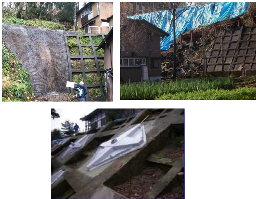
写 3-12 のり面保護工の変状の例
