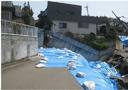
(c)腹付け盛土の崩壊の事例
