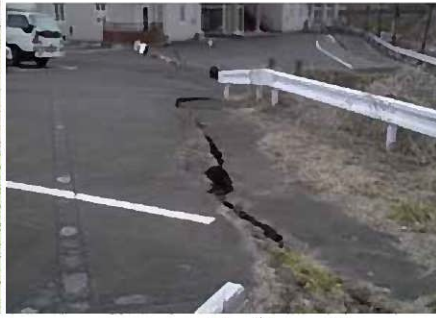
(b)のり肩の亀裂の事例
