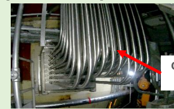
② CRD挿入引き抜き配管(北)
