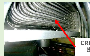
④ CRD挿入引き抜き配管(南)
