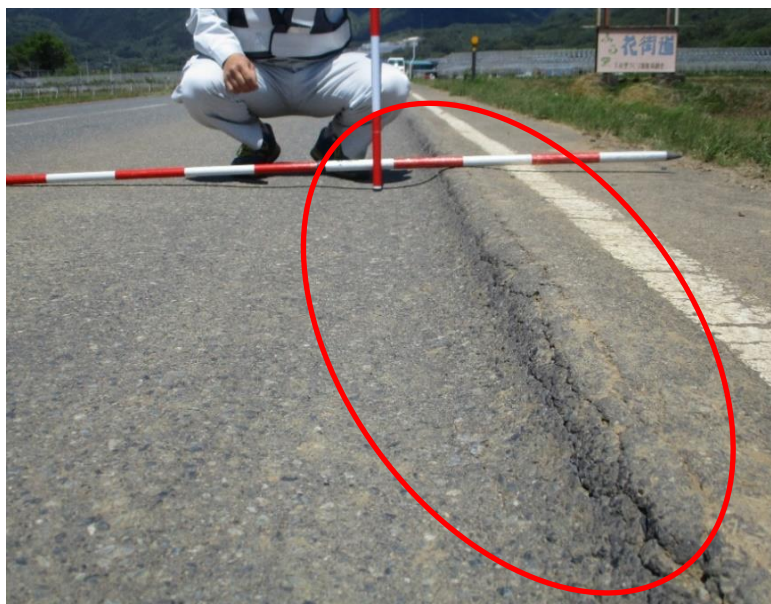
わだちの状況
