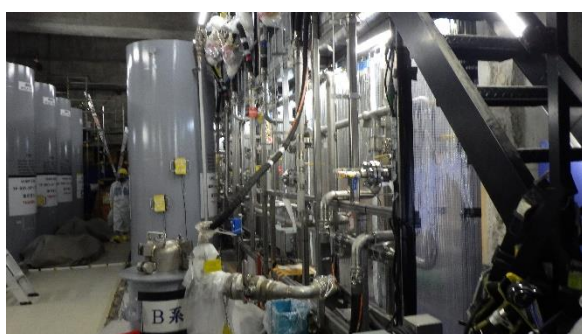
(写真 3) SARRYのバルブの設置状況
