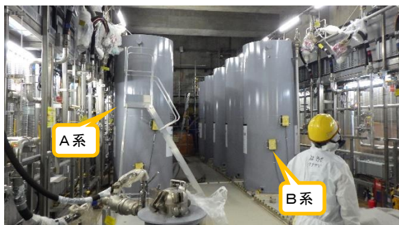
(写真 1) SARRYの吸着塔の設置状況
