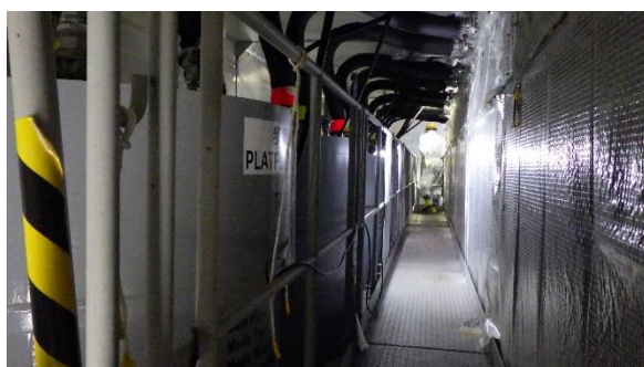
(写真 4 - 1) SARRY IIの吸着塔の設置状況① (手前 4 つが吸着塔で、奥 2 つがろ過フィルタ)
