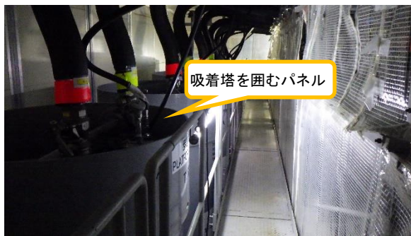
(写真 4－2) SARRY II の吸着塔の設置状況②
