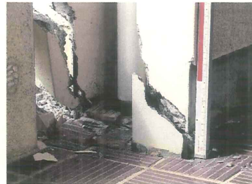
本館玄関亀裂
