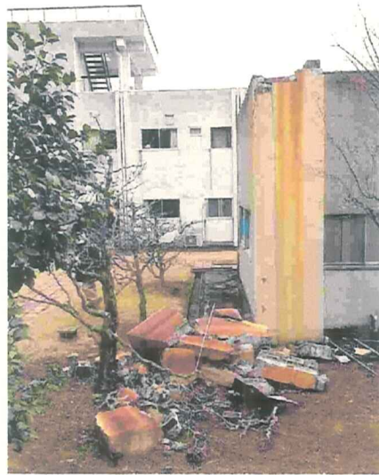
ボイラー室(煙突崩落)
