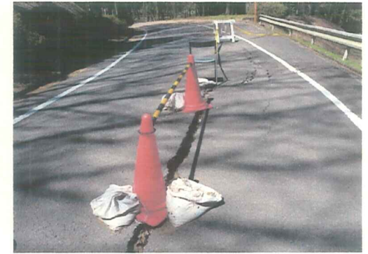
管理道路亀裂
