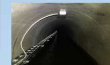
隧道内 電波レベル計
