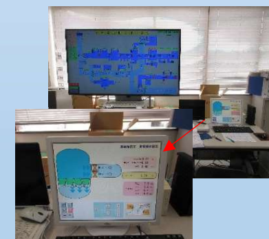
中央管理所の 遠隔操作システム
