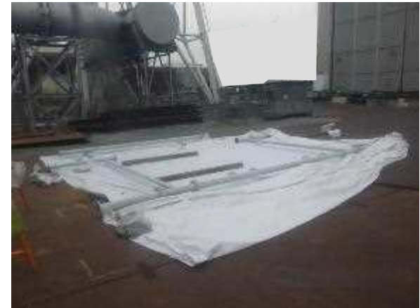
<起動変圧器周辺エリア>
