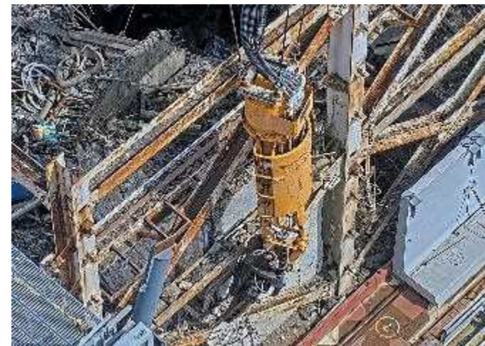
＜遠隔撤去機器＞
