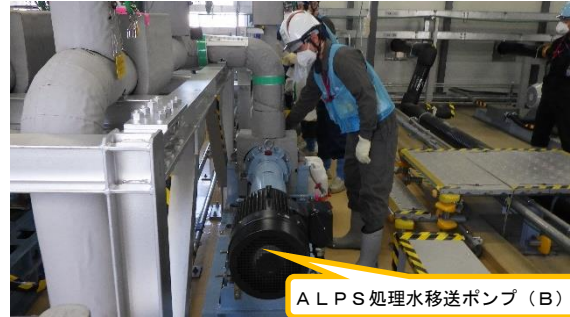
(写真2②) ポンプの稼働状況確認
