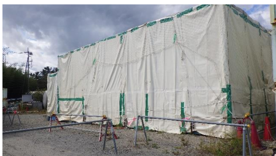
(写真 1) ノッチタンク保管状況
