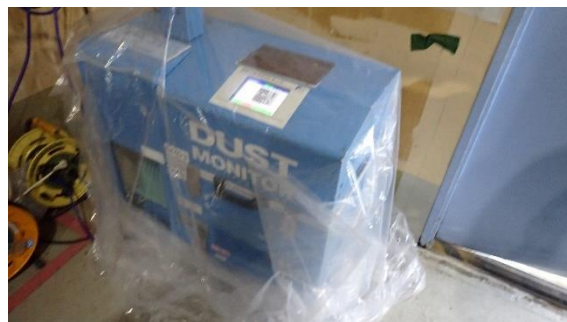
(写真 6) ダストモニタの設置状況
