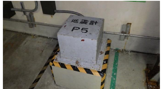
(写真 1 - 2) 地震計の設置状況② ※地下 2 階
