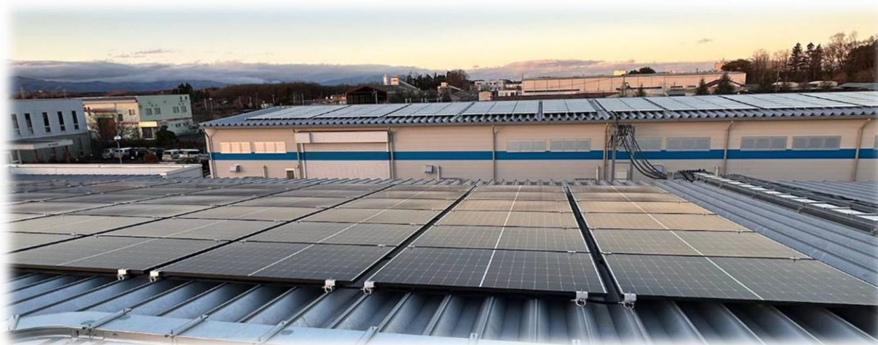
(株)アトック 太陽光発電設備 (205.5kW)
