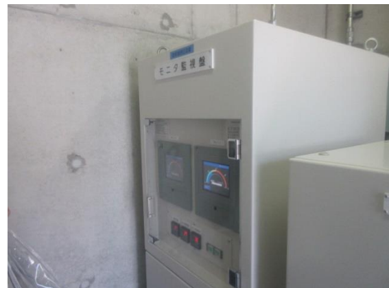
(写真 5 ②) 現場監視盤の設置状況
