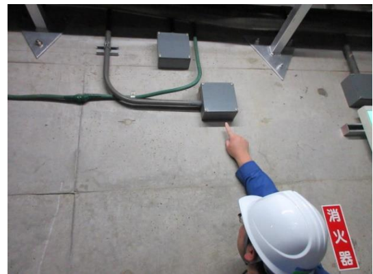
(写真 4) 水漏れが確認された電線管
