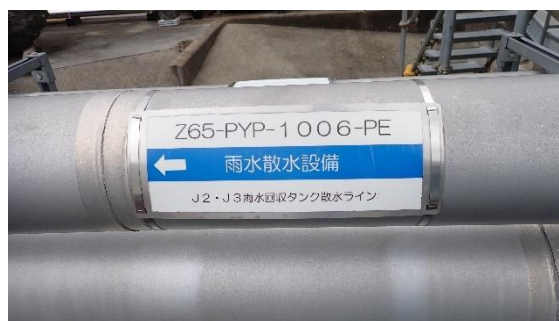
(写真2④) J2及びJ3雨水回収タンクからの散水ライン
