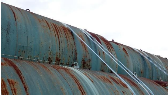
(写真 5 ①) 表面の腐食状況①
