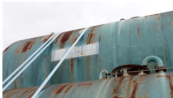
(写真 5 ②) 表面の腐食状況②
