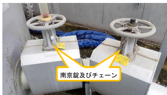
（写真1②）J2タンク払出弁の状況
