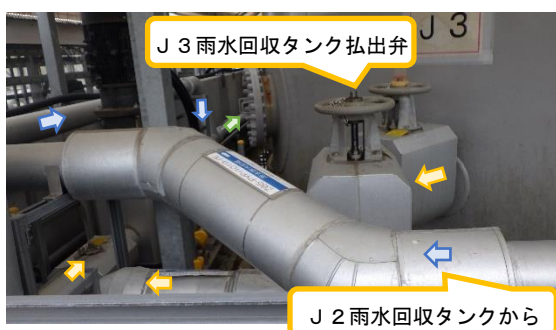
(写真2③) J3タンク雨水回収タンク払出弁 (閉状態)
