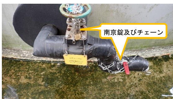
（写真1①）サンプリング弁の状況
