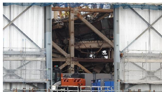
(写真2) 上部架構開口部の状況
