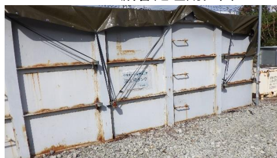
(写真 3－2) エリアM内の消火用 タンク等の配備状況
