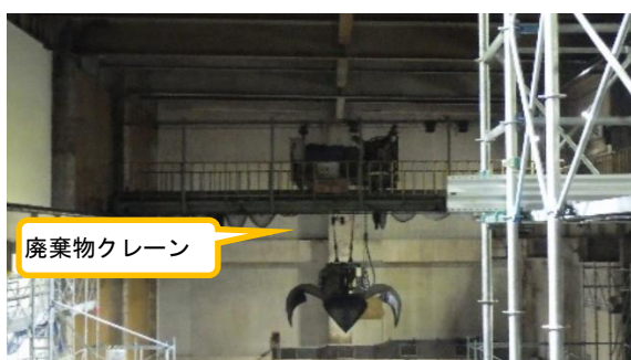
(写真 4－4) 廃棄物クレーン
