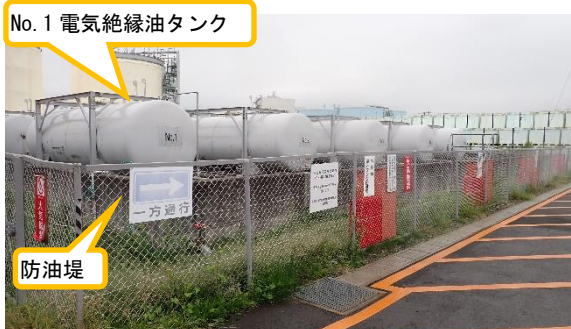
(写真 5 ①) 既設タンクの設置状況
