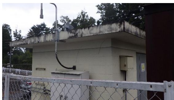
(写真 6-2) MP No. 7 の設置機器② (ダスト吸引口等)
