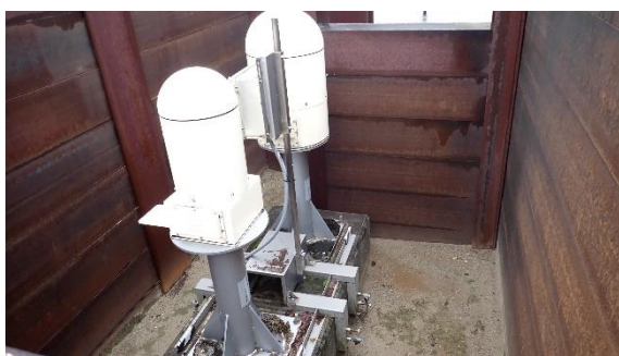
(写真 6-1) MP No. 7 の設置機器① (検出装置)
