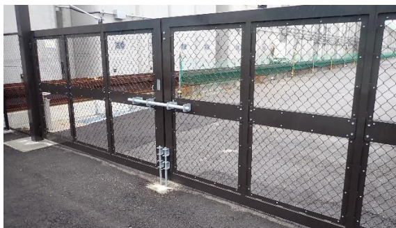
(写真 2-1) 南側エリアの新設物① （進入防止柵）
