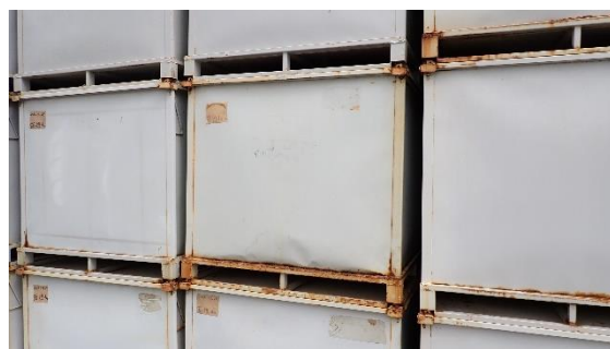
(写真 7 ①) 腐食の状況
