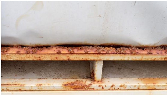
(写真 7 ②) 腐食部拡大
