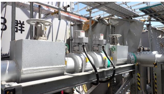
(写真4②) 払出弁の状況
