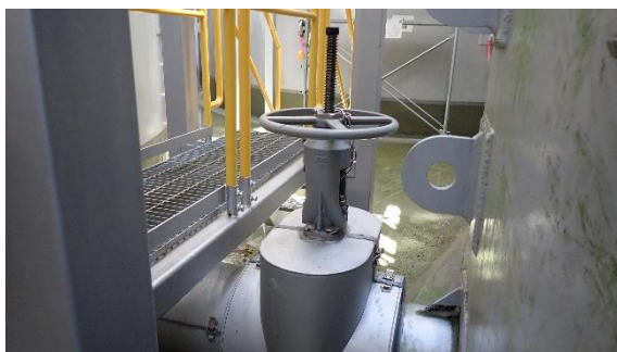
(写真 4 ④) 連結弁の状況
