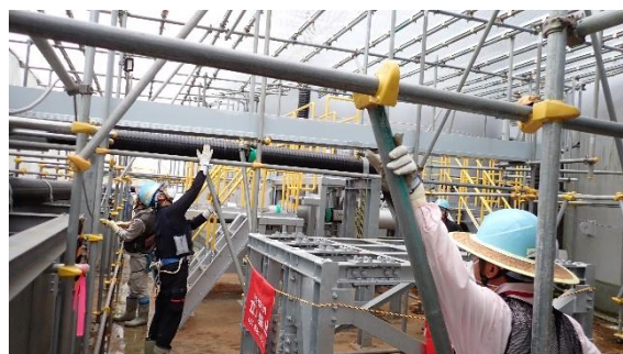
(写真 7) エリア西側の照明設置状況
