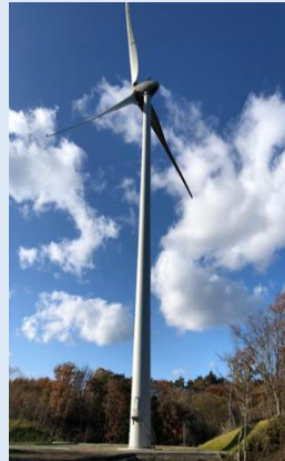
オフサイト風力発電設備
