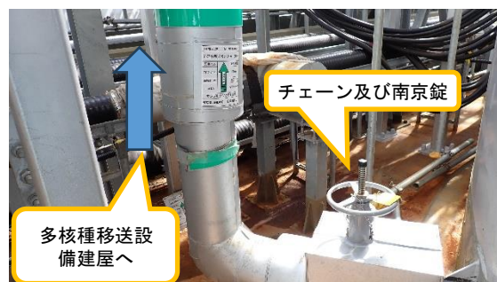
(写真1②) 払出元弁の状況
