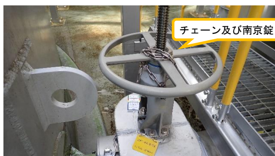
(写真1①) 連結弁の状況
