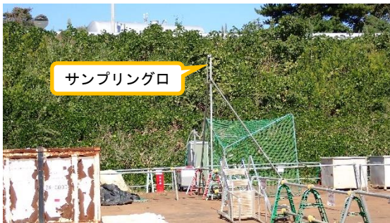
(写真7) ダストモニタ設置状況
