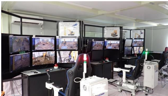
(写真 2) 遠隔操作室の状況
