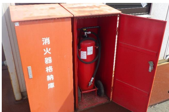
(写真10) 伐採木一時保管エリアV付近の消火器の設置状況
