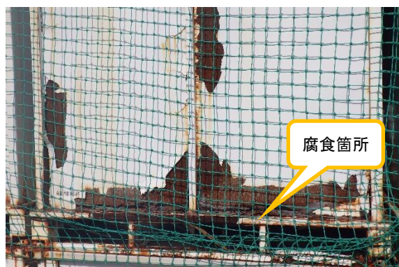
(写真15) 金属製コンテナの腐食状況
